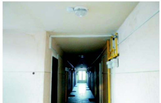
Fig. 3: Iluminat cu becuri cu senzori
